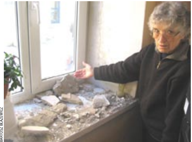
Szczęście w nieszczęściu, że tynk oderwał się nad oknem, a nie nad moim łóżkiem – mówi Ryszarda Huk.
