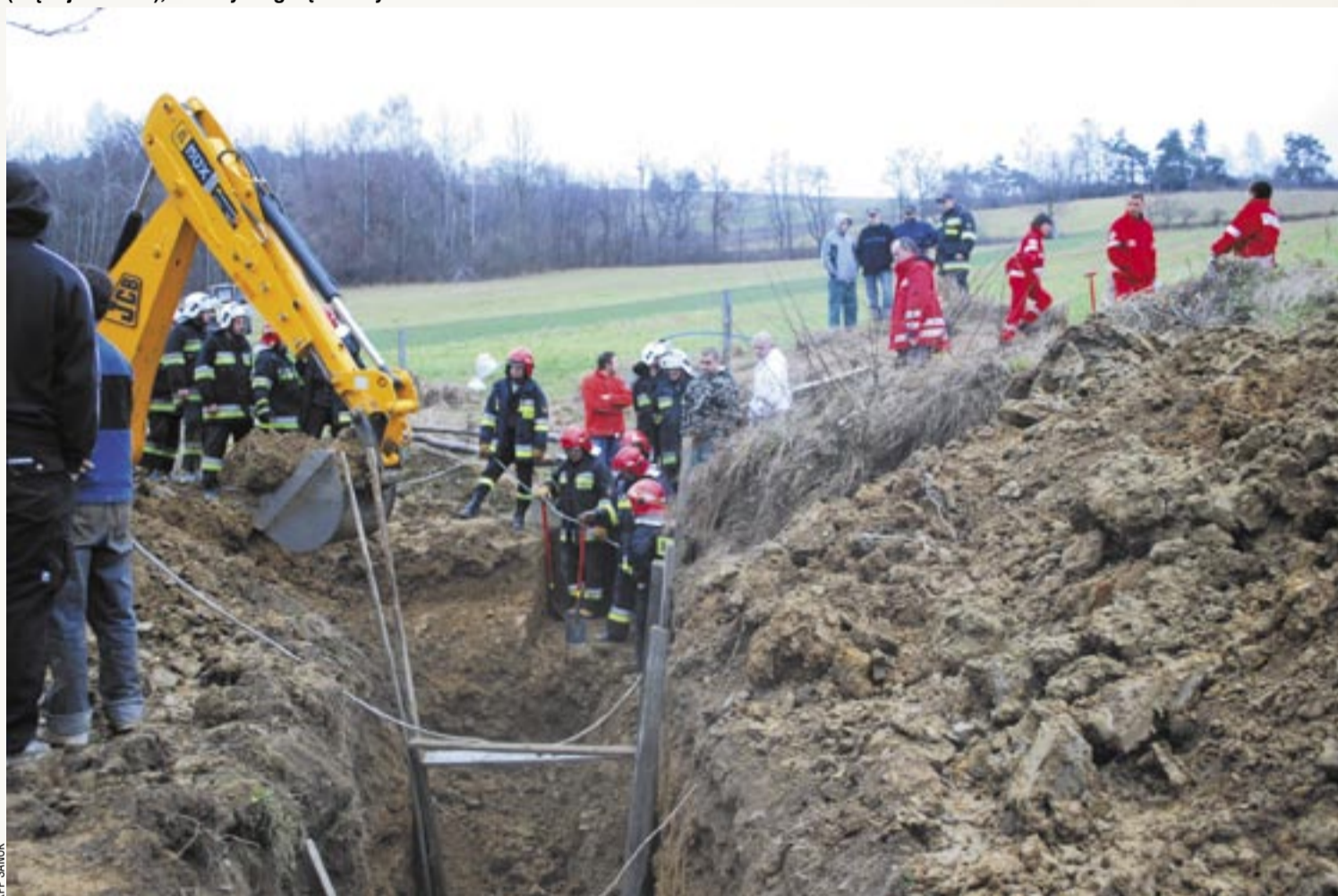
W wydobyciu ciał z zawalonego wykopu pomagali strażacy sanockiej PSP i OSP oraz ekipy medyczne. Na uratowanie ofiar było, niestety, za późno.
