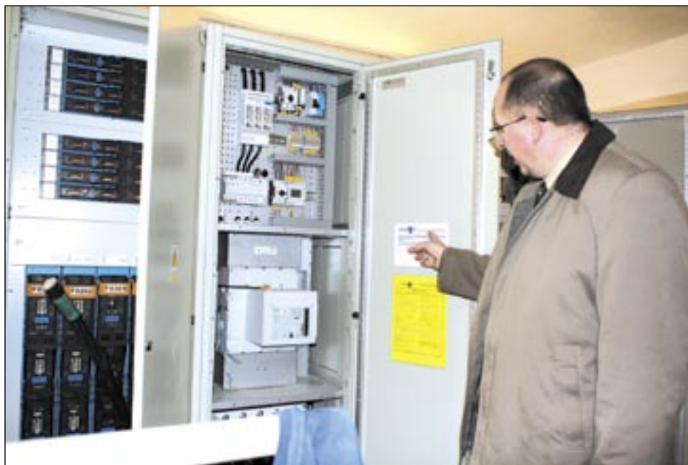
Z rozwiązaniami energetycznymi Szpital wkracza w XXI wiek. Dzięki nim będzie posiadał zasilanie z podwójnych źródeł, a jak i te wysiądą, sama technika przełączy się na agregat prądowłoczy.
