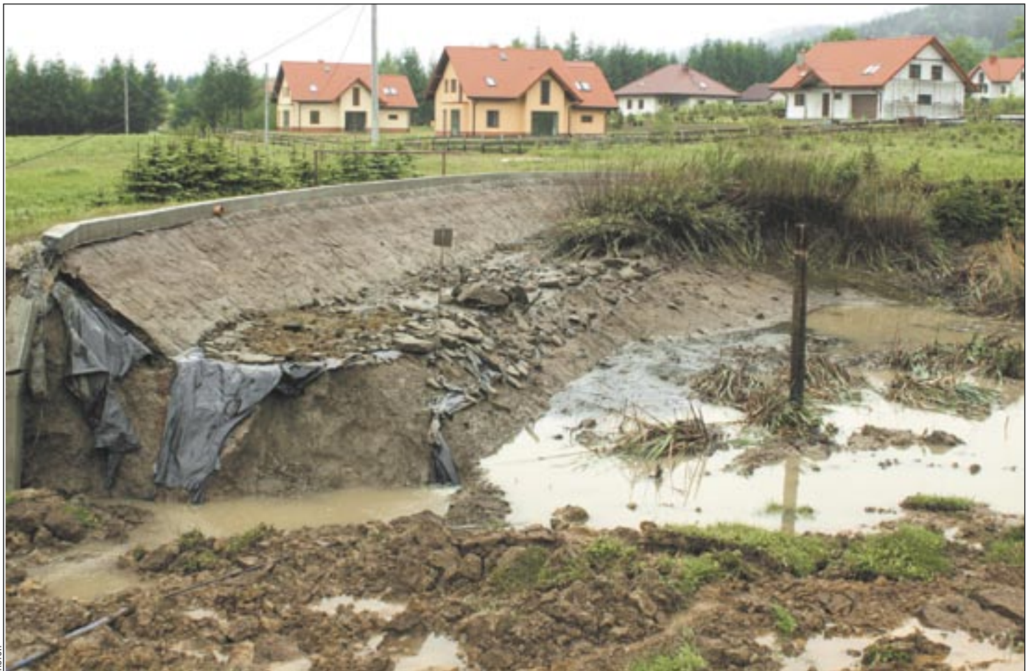
Woda to prawdziwy żywioł. Stawom w Bykowcach nie pomogły nawet umacniane brzegi. Konstrukcja ze zbrojonego betonu pękła jak przysłowiowa zapalka.
