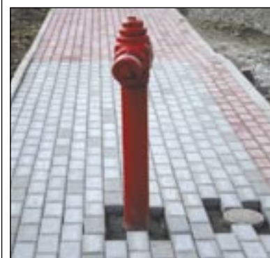
Czerwony hydrant na środku chodnika daje gwarancję, że w przypadku potrzeby jego użycia nie trzeba go będzie szukać.
