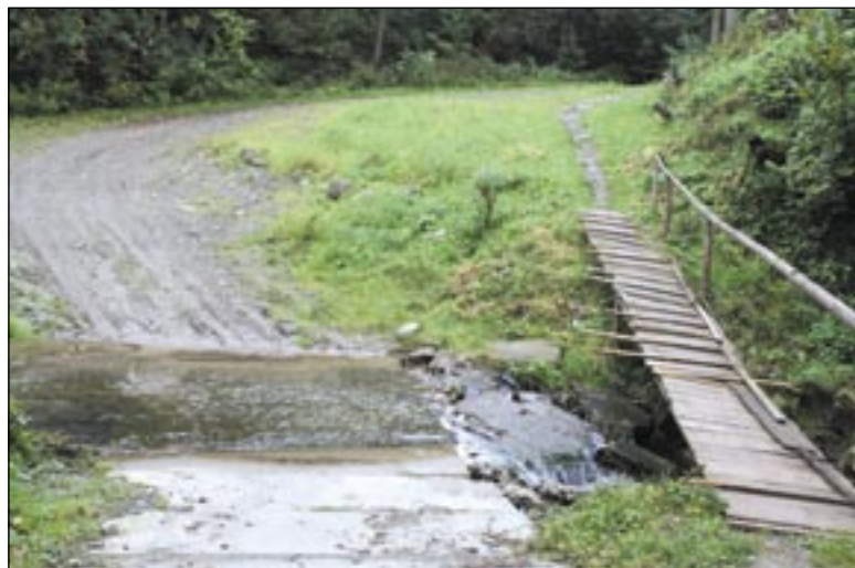
Mamy XXI wiek. Tak wygląda „droga” prowadząca do ludzkich domostw w miejscowości Liszna. Za niespełna dwa miesiące tą drogą mieszkańcy ci pójdą do wyborów samorządowych. Czy pójdą?
