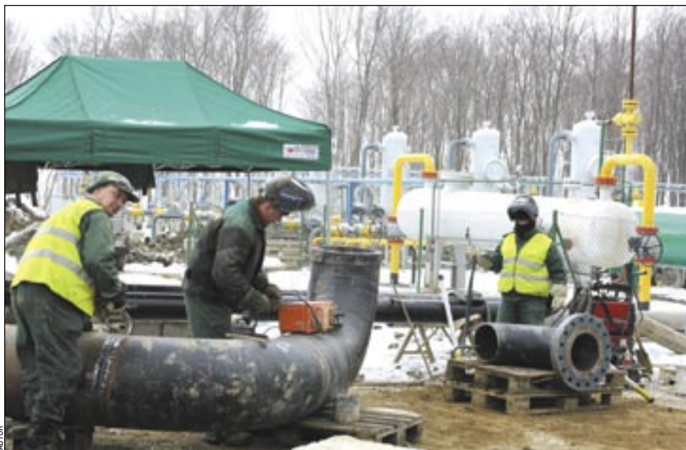
Strachocina stała się największym placem budowy w powiecie sanockim. Inwestycję pn. „Rozbudowa podziemnego magazynu gazu” realizuje konsorcjum, angażując kilkanaście firm podwykonawczych. Kiedy odwiedziliśmy plac budowy, pracowało na nim 240 pracowników.
