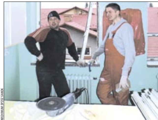
Wystarczyło wymienić okna, aby przekonać się jak bardzo Oddziałowi Noworodków potrzebny jest remont.
