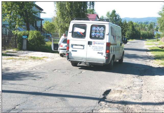
Remont ulicy Chrobrego to prawdziwa układanka finansowo-techniczna. Miejmy nadzieję, że nie odbije się to na jakości prac...
