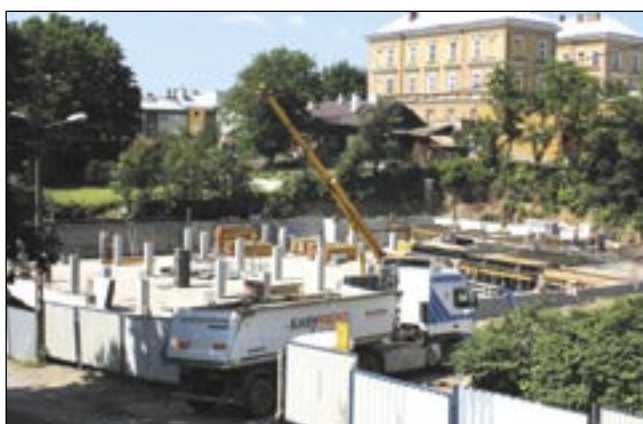
Budowa obiektu handlowo-usługowego przy ul. Feliksa Gieli wyszła spod ziemi. Czy rzeczywiście w tym roku będziemy tam robić zakupy?
