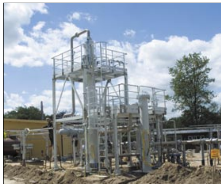
Kopalnia Żołynia koło Łańcuta. Nafta-Gaz-Serwis wykonała tam kompleksową modernizację instalacji przygotowania gazu
