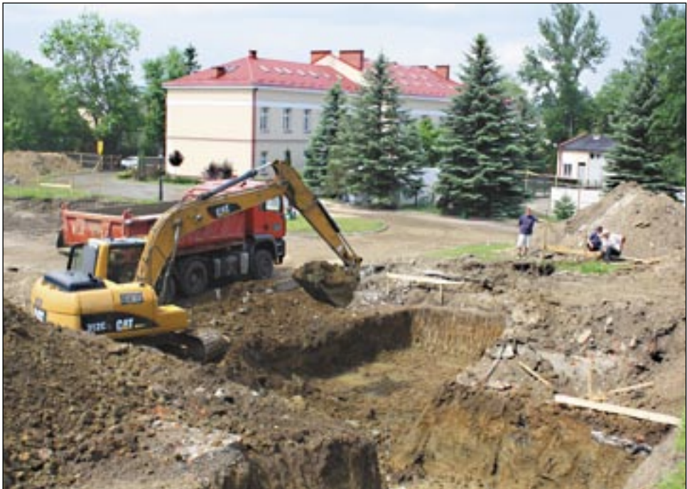
Prace ziemne już ruszyły. Jeżeli wszystko pójdzie zgodnie z planem, obiekt będzie gotowy w 2015 roku. A może i wcześniej...
