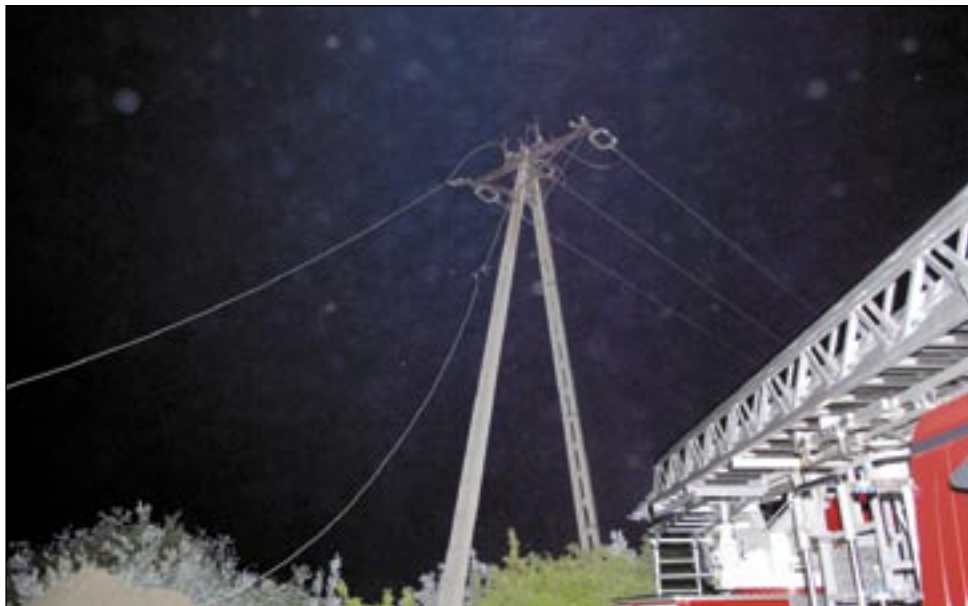
22-latek wykorzystał limit szczęścia na dłuższy czas – gdyby nie uzbrojenie rozciągnięte między filarami słupa, w które się zaplątał, spadłby z wysokości 8 metrów...
