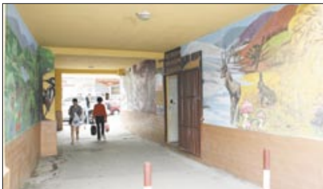
Przechodniom smród wykręca nosy, a w oczu rzucają im się zacieki przy ścianach. Czas na solidne szorowanie.
