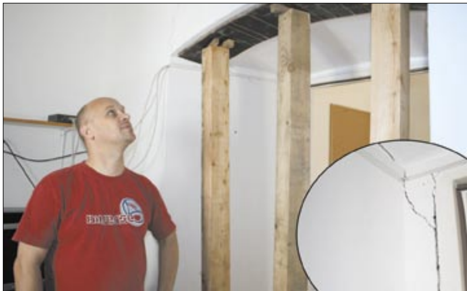
Budynek MDK był remontowany w ubiegłym roku. W tym sezonie także będzie wymagał drobnych prac naprawczych.
