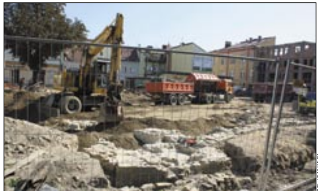
Koniec „wykopków” na placu św. Michała. Pozostanie po nich cenny skarb w postaci fragmentów muru XIV-wiecznego kościoła. Sanocznianie zadają sobie pytanie: czy godnie będą wyeksponowane?
