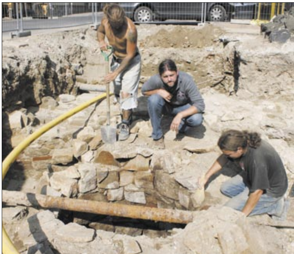
Ciekawe, czy woda w studni będzie nadawała się do picia? A może to cudowna woda?! Miejsce można naprawdę świetnie zagospodarować – studnię podnieść, oczyścić i zabudować. A może nawet urządzić uliczny zdroj, który w upały byłby dużą atrakcją.
