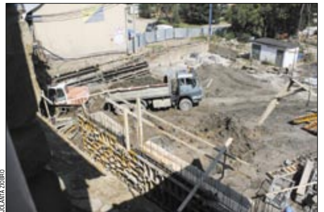
Budowa spowodowała odpływ wód gruntowych, skutkiem czego jest osiadanie sąsiadującego z placem budowy MDK.
