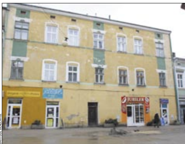
Kamienica przy ul. 3 Maja jest już w opłakanym stanie. Remont wydaje się koniecznością.
