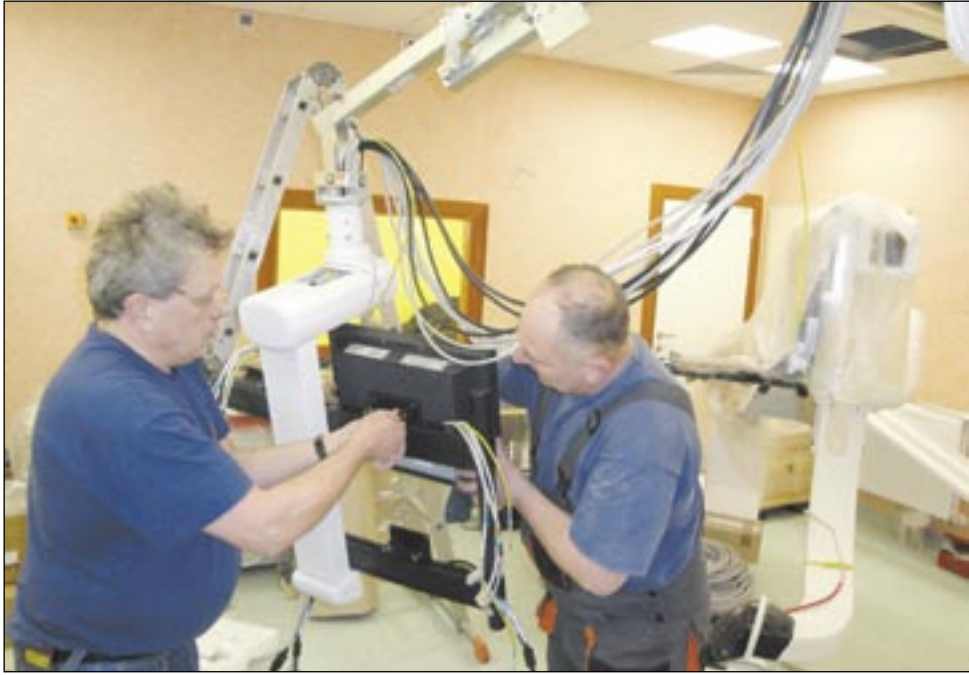
Montaż angiografu to ostatnia już operacja przed otwarciem Pracowni Radiologii Zabiegowej. Kolejna za niespełna miesiąc, ale już na pacjentach.
