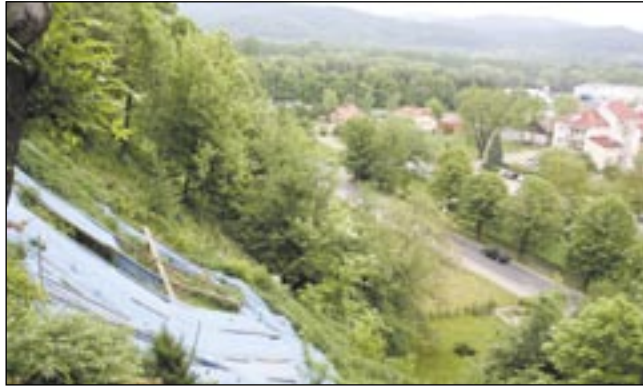
Osuwisko na skarpie miejskiej wymaga pilnego zabezpieczenia.
