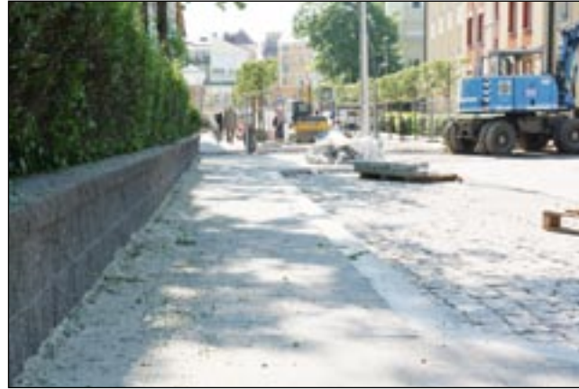
Tej szerokości chodnik na deptaku to jakiś niestosowny żart projektantów. Zwłaszcza, że po drugiej stronie ulicy jest on kilkunastometrowej szerokości.
