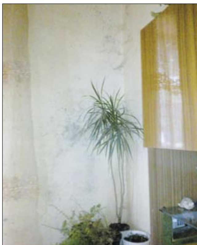
Naloty pleśni widać nie tylko za meblami – tak wyglądają ściany w kilka miesięcy po remoncie mieszkania...
