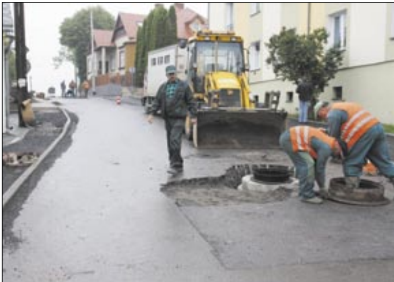
Ze względu na prace ulica Słowackiego przez kilka ostatnich dni była zamknięta.
