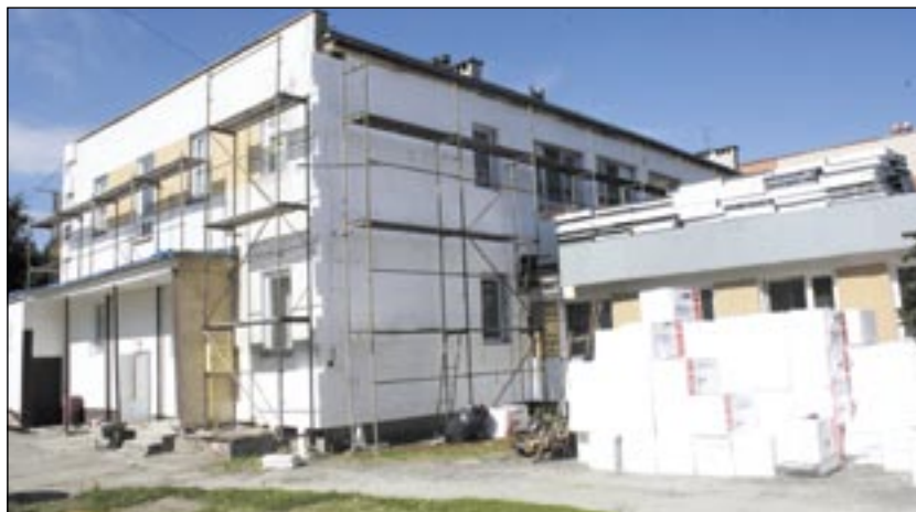
W żłobku, czy przedszkolu ciepła atmosfera jest ważniejsza od temperatury, chociaż termomodernizacja na pewno poprawi wygląd tych obiektów i spowoduje obniżenie kosztów ogrzewania.
