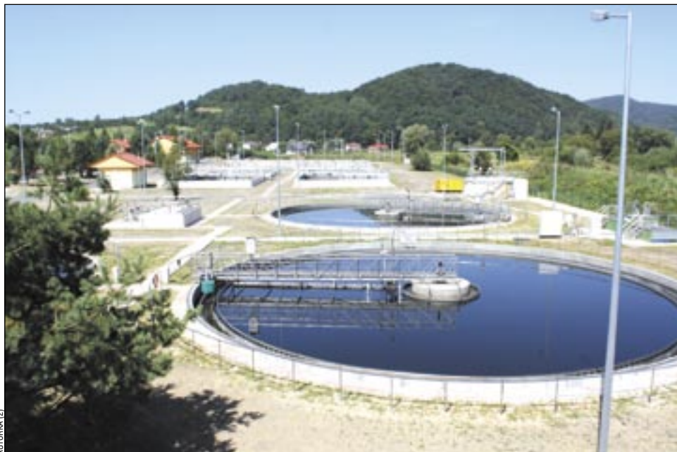
Z widocznych na zdjęciu osadników odpływają już oczyszczone ścieki do Sanu. Projektowana wydajność oczyszczalni wynosi 15 tys. m 3 na dobę.
