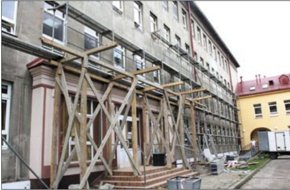
Już za kilka miesięcy sanocki szpital przestanie straszyć obskurnymi, szarymi murami. Operacja ocieplenia (wizerunku) szpitala rozpoczęła!
