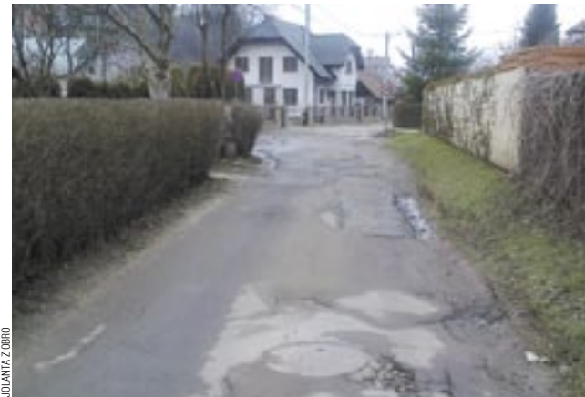
Brak podbudowy, odwodnienia, nieskończona liczba „lat”. Tak, niestety, wygląda część dróg w mieście. Na zdjęciu – ulica Kollątaja.
