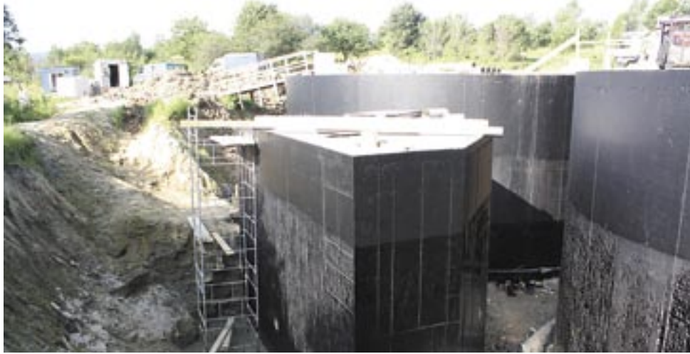
Największe inwestycje, związane z projektem „Poprawa gospodarki wodno-ściekowej w aglomeracji Sanok”, o wartości 124 mln zł brutto, realizowano w latach 2011-2013. Na zdjęciu – budowa zbiorników wyrównawczych przy ul. Kenara.
