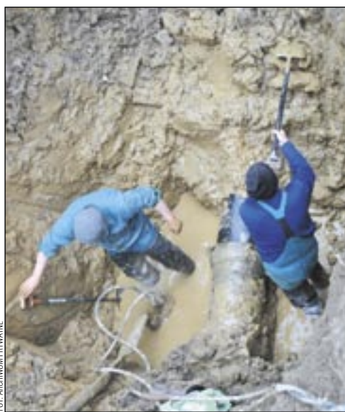
Na starszych odcinkach sieci wycieki to codzienność. Dlatego SPGK inwestuje w monitoring.
