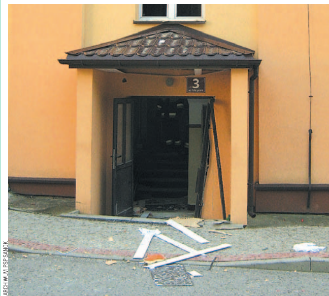
Zniszczone na skutek wybuchu drzwi wejściowe do budynku...
