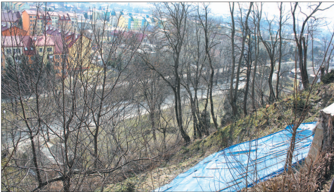
Osuwisko na skarpie wygląda „niewinnie”, ale specjaliści twierdzą, że jest nawet bardziej niebezpieczne niż to na Górze Parkowej. Jego zabezpieczenie będzie wyzwaniem od strony technicznej, nie mówiąc o kosztach.
