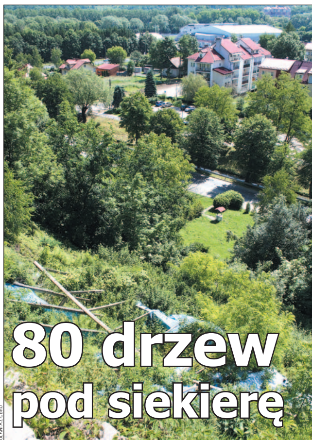
Skarpa i osuwisko pokryte są „buszem”, który trzeba będzie usunąć w trakcie prac zabezpieczających.
