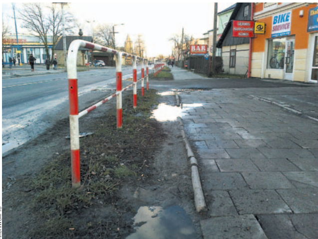
Mieszkańcy od dawna zwracają uwagę na fatalny stan chodników i konieczność ich wyremontowania
