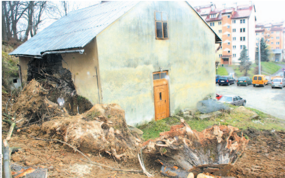
W 2010 roku spadające drzewo uszkodziło budynek komunalny położony na terenie osuwiska. Na szczęście nikt w nim już nie mieszkał
