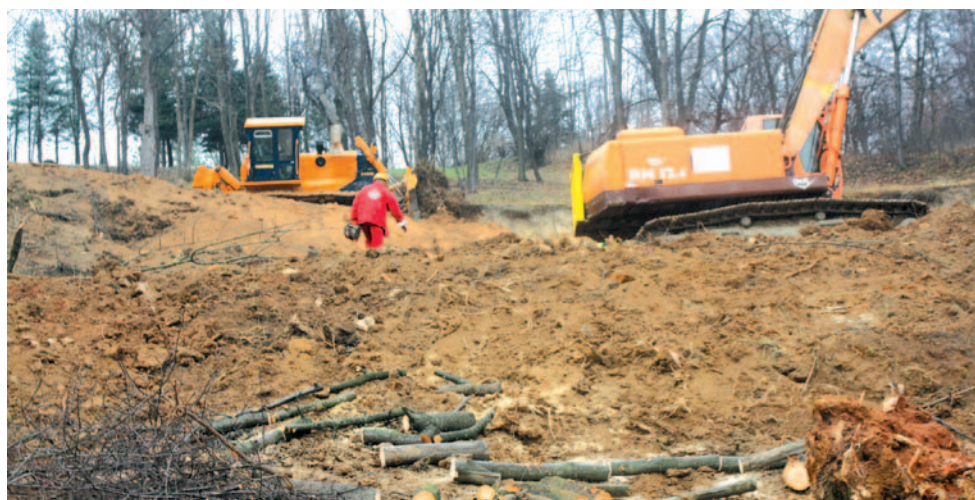
W związku z uaktywnieniem osuwiska od strony ulicy Kościuszki wycięto dziesiątki drzew na południowym stoku Góry Parkowej
