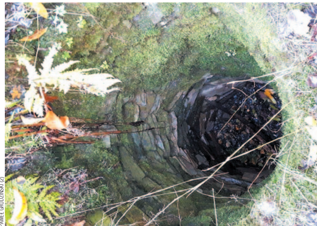
Studnia przed zabezpieczeniem
