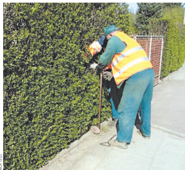
Pracownicy SPGK „walczą” z zaworem wody na spornym gruncie
