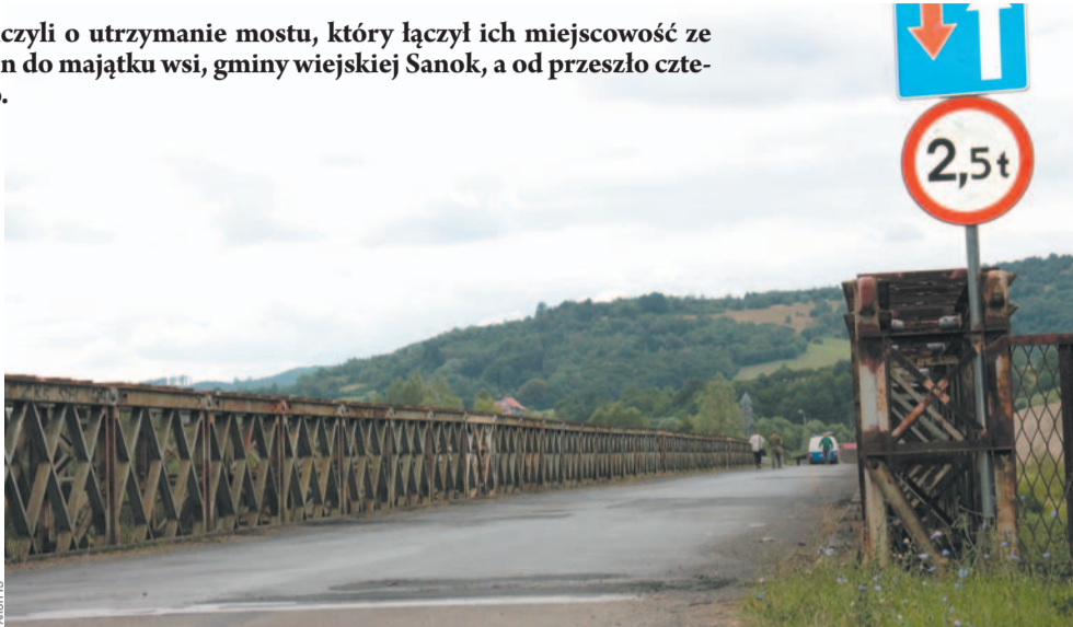
Most w Dobrej przed generalnym remontem. Widać zardzewiałe elementy konstrukcji, brak kładki dla pieszych (zdjęcie poniżej)
