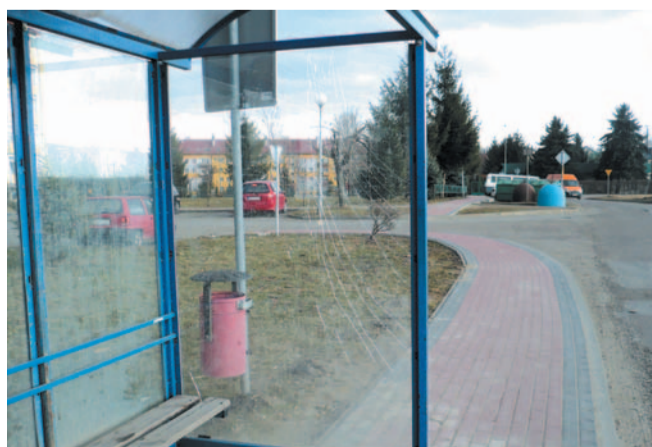
Zniszczony przystanek przy ulicy Kawczyńskiego
