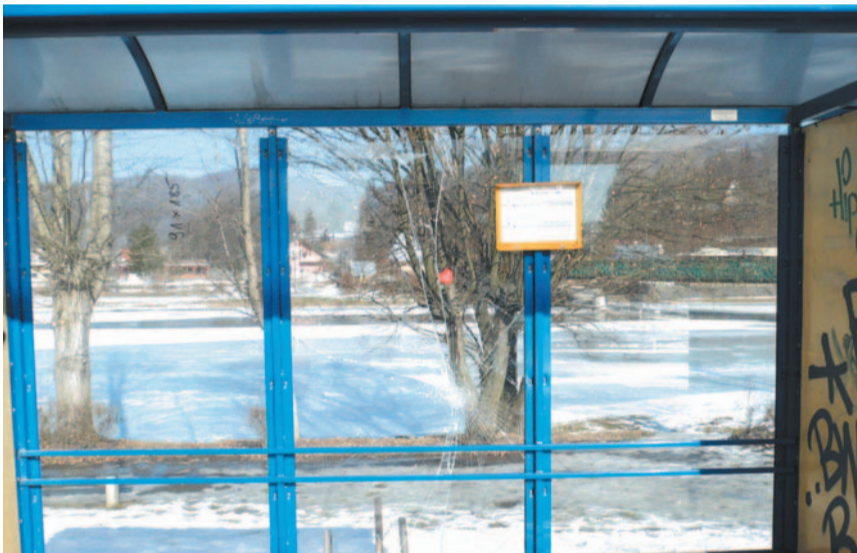
Pęknięta szyba wiaty przy ulicy Białogórskiej
