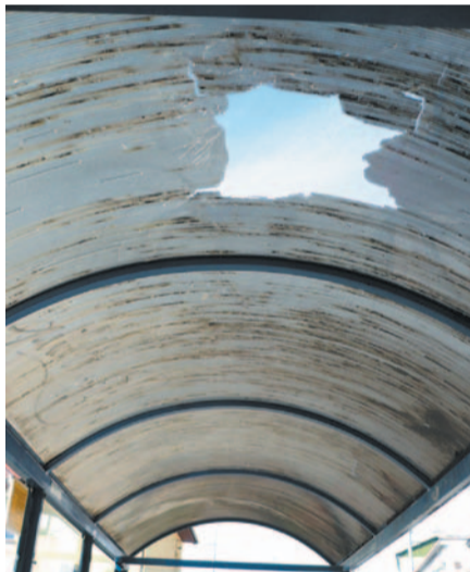
Uszkodzony dach przystanku przy ulicy Słowackiego, na wysokości galerii handlowej
