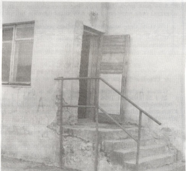
Zniszczone drzwi, odpadające tynki.
