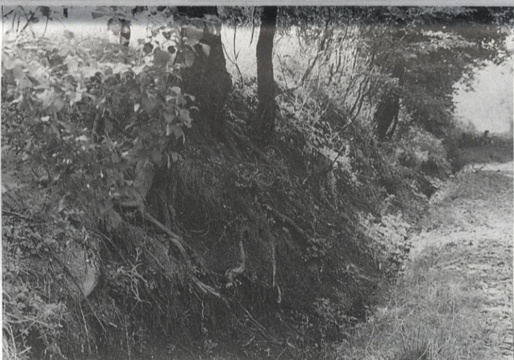
Łyżka koparki wybrała tak głęboki i stromy rów, że dziś sphywająca nim woda podmywa mieszkańcom ogrodzenia i rosące na brzegu drzewa
