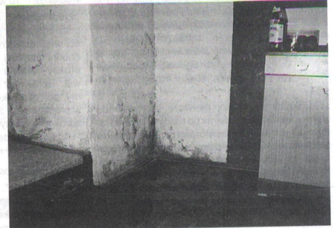
Tak wyglądają ściany w kuchni państwa Dobków, którą zaadaptowali samodzielnie z korytarza. Szare plamy przy podłodze to wykwyty grzyba.
