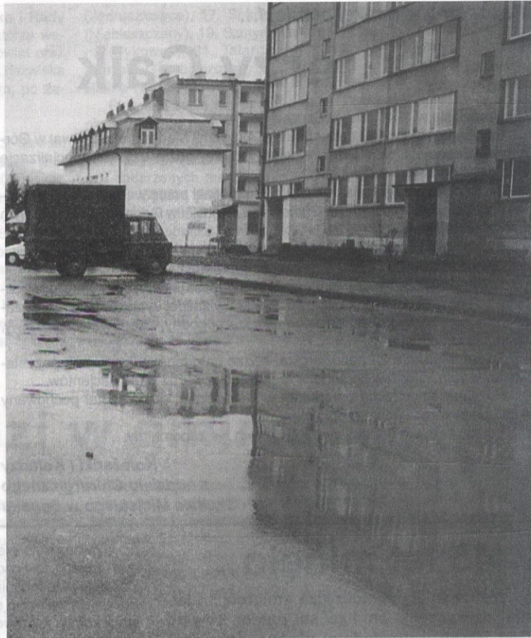
Deszczówka nie chce płynąć pod górę... (ulica Sadowa).
