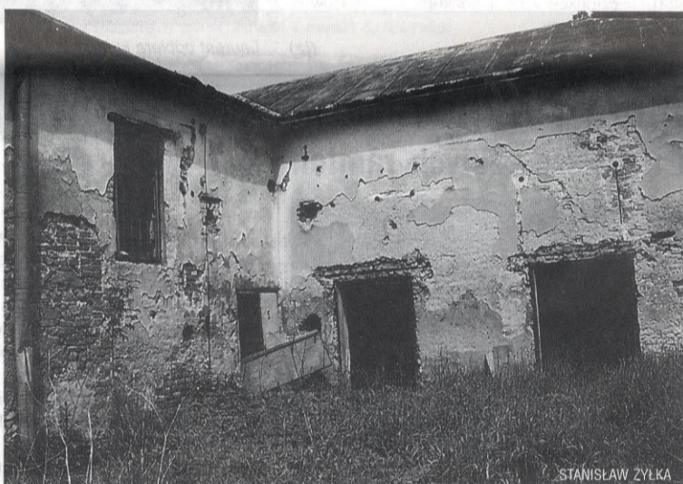
Zdewastowane obiekty dawnych koszar.
