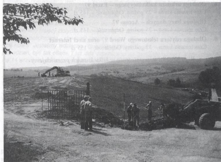
Mieszkańcy Posady oddychają z ulgą – skończyła się wysypiskowa udreka. Kiedy hałdę porośnie trawa i drobne krzewy, wtopi się ona w krajobraz
