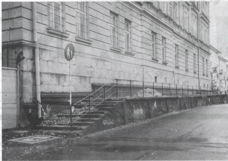
Budynek sanockiej policji grozi katastrofą budowlaną.
