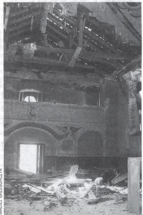
Wnętrze cerkwi w Baligrodzie po czerwcowej katastrofie.
