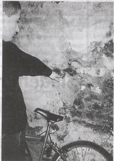
Tak wyglądają ściany w piwnicy budynku przy ul. Dworcowej.
