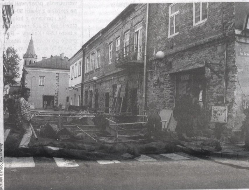
Ulica Grodka w chwilę po zawaleniu się rusztowania.
