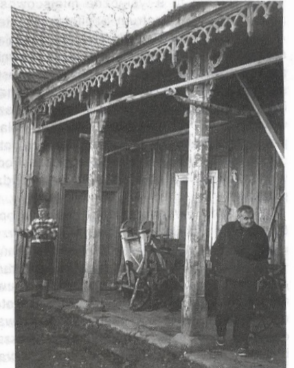
Henryk Olszański dokonuje wizji lokalnej na tyłach budynku – tu na szczęście filary jeszcze się ostały.
