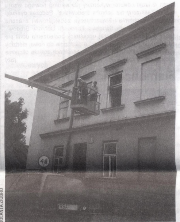
Mieszkanie na piętrze zostało zabezpieczone przez zamurowanie drzwi. Z drugiej strony przez okna wlewa się deszcz, co na pewno nie polepszy stanu technicznego budynku.
