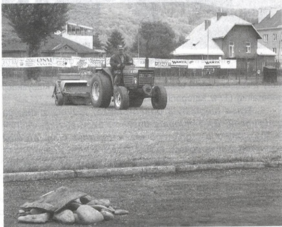
Podczas prowadzonych prac remontowych największym problemem okazały się kamienie, które znajdowały się kilkanaście centymetrów pod ziemią
