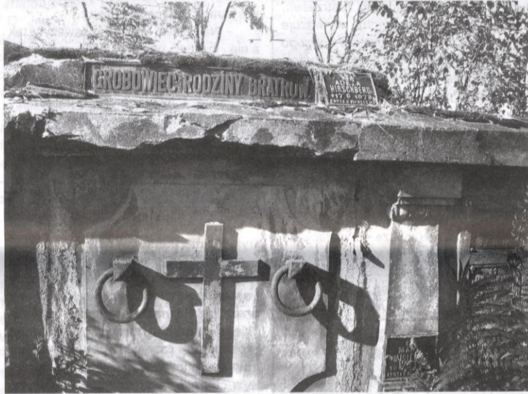
A to zwykły cementowy grobowiec, choć kryjący prochy bohaterów z rodziny Bratrów. Wymaga pilnej renowacji.
